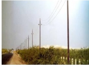
الصورة (15): أعمدة الكهرباء
